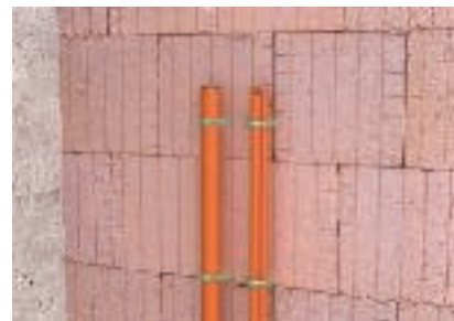
Pionowa instalacja kabli pojedynczych oraz w wiązkiach na ścianie
