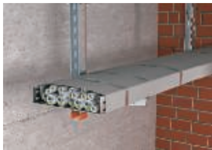
Kompletna osłona podwieszanej trasy kablowej
