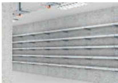
Tunel kablowy z bandażami w elektrowniach
