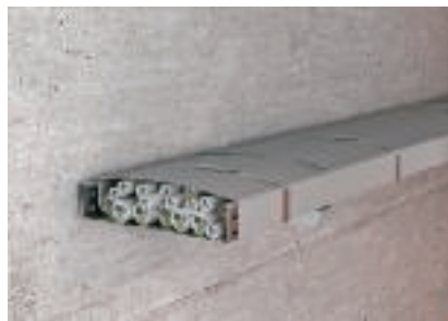
Kompletna osłona trasy kablowej mocowanej na ścianie
