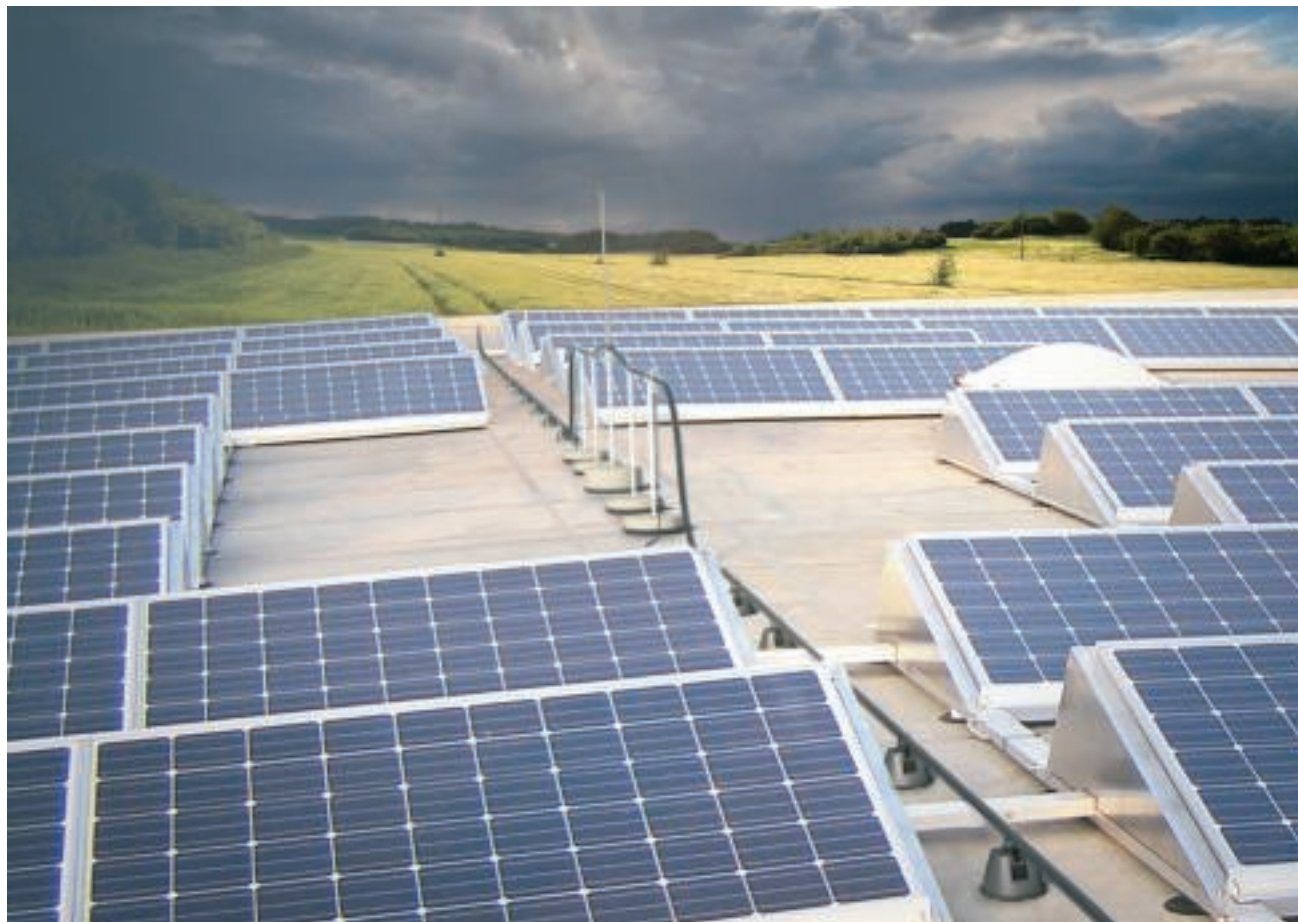
Dach płaski z systemem fotowoltaicznym oraz izolowanym kablem isCon®
