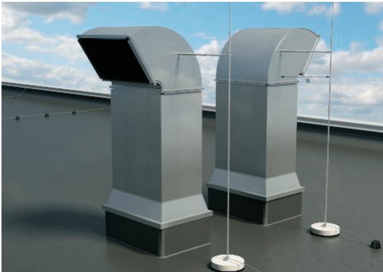
Maszt z zestawem Iso-Combi w celu zapewnienia odstępu izolacyjnego (s)
